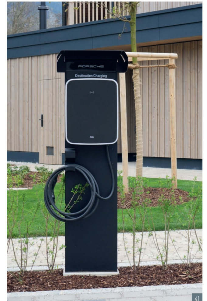
1) Die PV-Anlage auf den Dächern unterstreicht das umweltbewusste Konzept des Chaletdorfs. | Bild: © Franziska Mayer 2) Batteriespeicher der PV-Anlage 3) Brandmeldezentrale 4) Ladestation für E-Fahrzeuge Bilder: © BAUER
